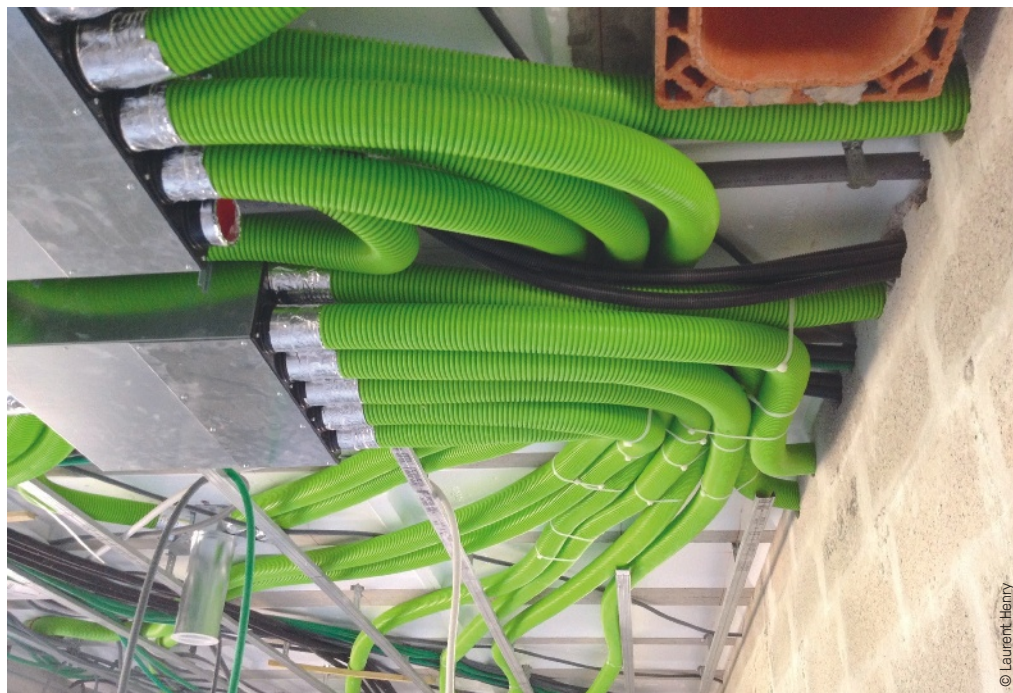
Réseaux pieuvre d'extraction et d'insufflation nettoyable en PEHD. Boîtiers de distributions en faux plafond.
